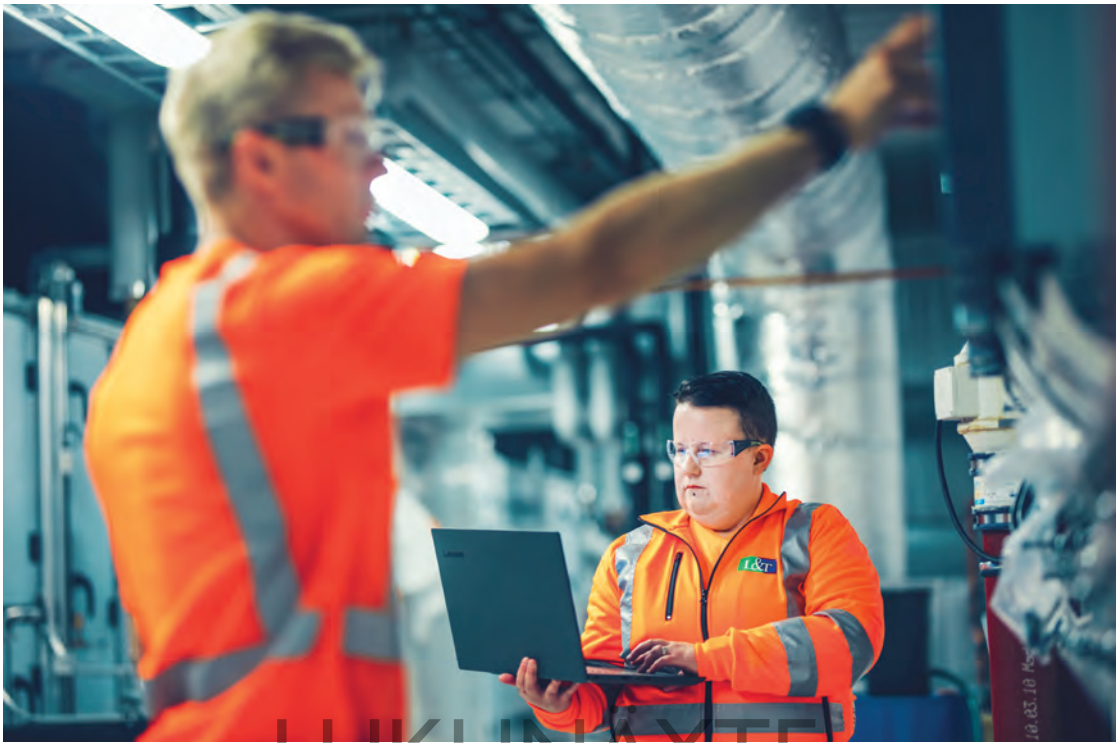
Kiinteistöhoitaja kirjaamassa havaintojaan. Kuva: Lassila & Tikanoja
