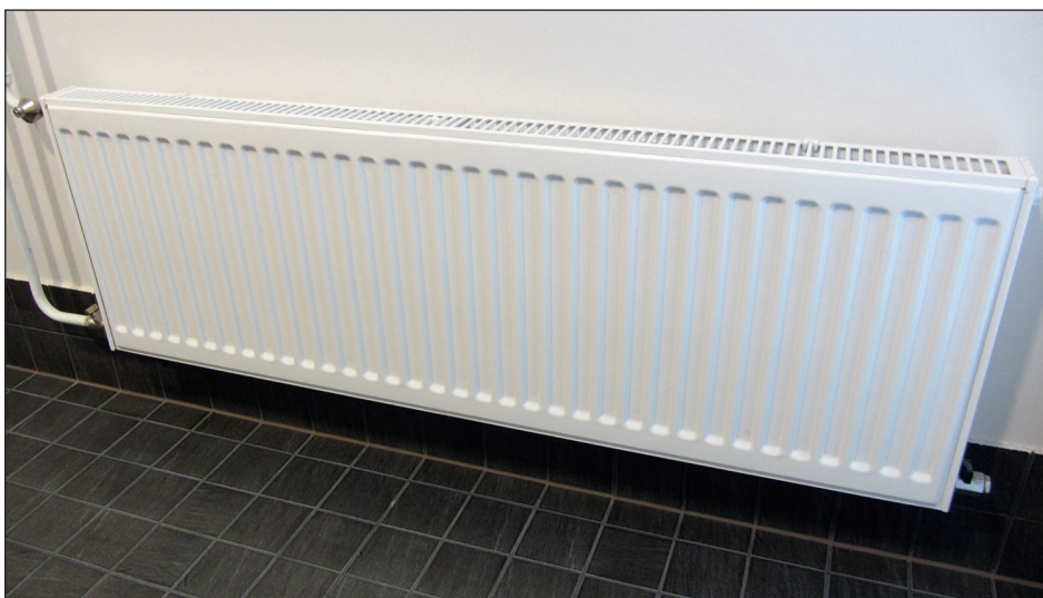
Kuva 37. Vuonna 2016 asennettu nykypatteri asuinrakennuksessa. Kuva: Kiinteistömedia Oy.
