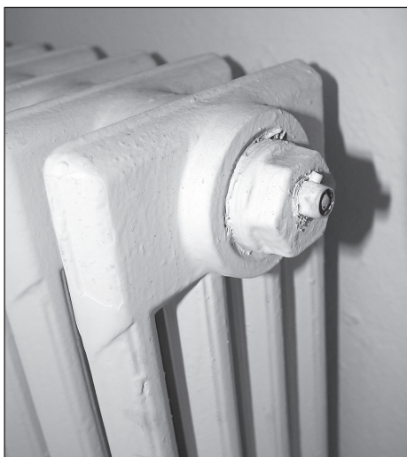
Kuva 46. Vanhanmallisen lämmityspatterin ilmausruuvi. Kuva: Kiinteistömedia Oy.
