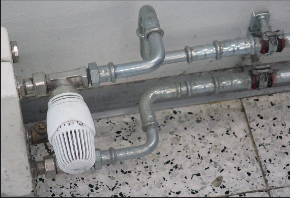
Kuva 42. Vuonna 1998 asennettu termostaattinen patteriventtiili. Kuva: Tapio Korkala.
