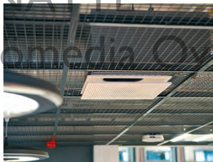
Kuva 4.3. Alaslaskettu katto. Kuva: Tatu Käpymäki
