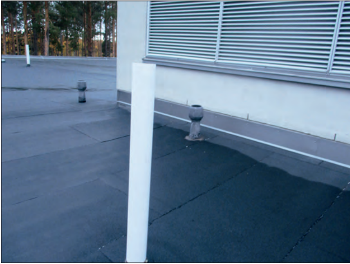
Kuva 41. Ulkoilmasäleikön riskiasennus. Riskinä on, että edessä olevasta valkoisesta tuule- tusviemäristä leviävät hajut tuulen mukana kuvassa taka-alalla oleviin tuloilmakoneiden ulkoilmasäleikköihin ja aiheuttavat hajuhaittoja sisäilmassa. Kuva: Tapio Korkala.
