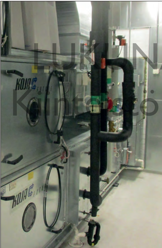
Kuva 40. Tuloilmakoneen jäähdytysosan viemäröinnissä on musta vesilukko ja taaemman osan viemäröinti on johdettu lattia-rajassa samaan konehuoneen lattiakaivoon. Kuva: Tapio Korkala.
