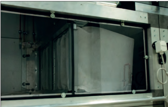
Kuva 46. Suodattimia tuloilmakoneessa. Kuva: Tatu Käpymäki.
