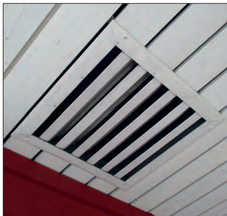
Kuva 42. Uuden rivitalon huoneistokohtaisen tuloilmakoneen ulkoilmasäleikkö on asennettu ulko-oven katoksen rakenteeseen, jolloin sade ei pääse säleikön sisään. Myös virtausaukot ovat riittävän isot, jotta säleikkö ei ole liian ahdas vaikuttaakseen tuloilmapuhaltimen toimintaan. Kuva: Tapio Korkala.
